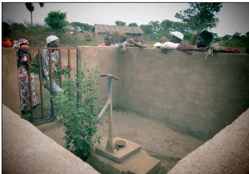
Photo 7 : Un point d'eau endommagé à Demgoya
