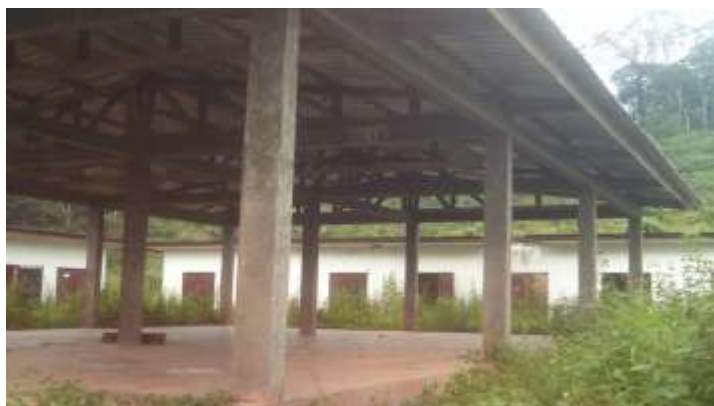
Photo 5: Une vue du Hangar du marché de Ndom centre abandonné
