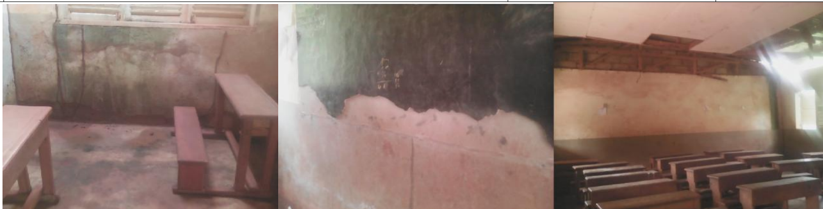
Photo 4 :Salle de classe en mauvais état
