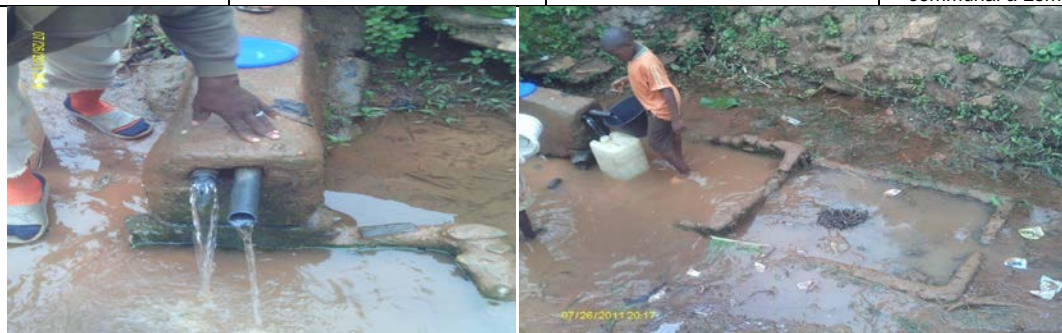
Photo 4: Point de Captage d'eau de la ville.
